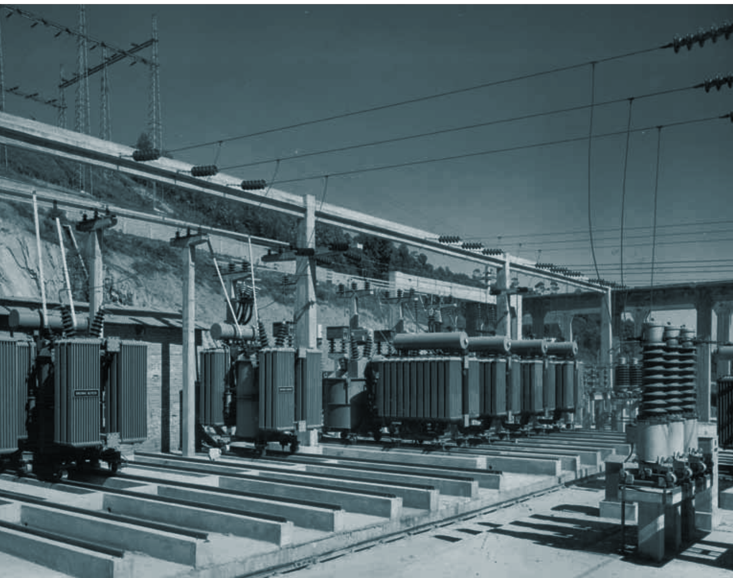
▲ Conjunto dos transformadores Brown Boveri da Usina do França (anos 1950)
